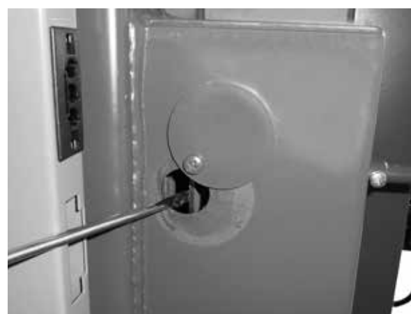
Kontrola i oczyszczanie regulatora proporcji powietrza pierwotnego i wtórnego poprzez otwór techniczny
